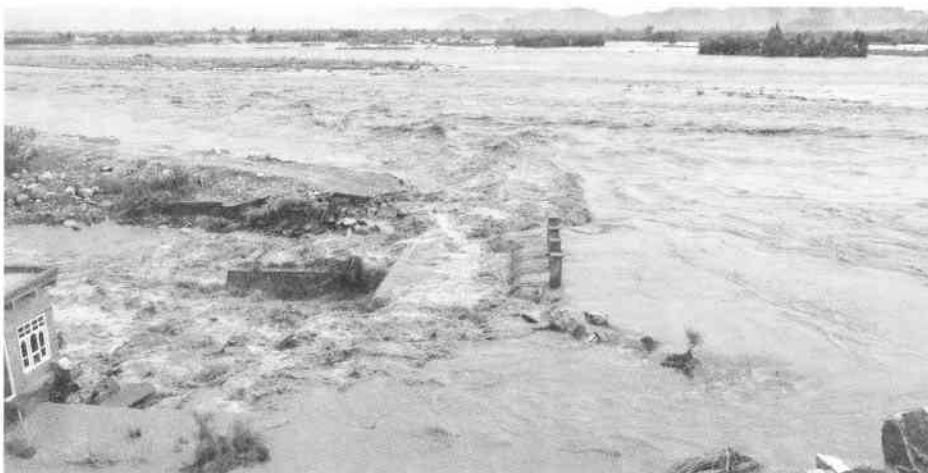
取水門を乗り越える2010年の大洪水。気候変化は湯水だけでなく、突発的かつ局所的な洪水を引き起こす(2010年7月30日)
