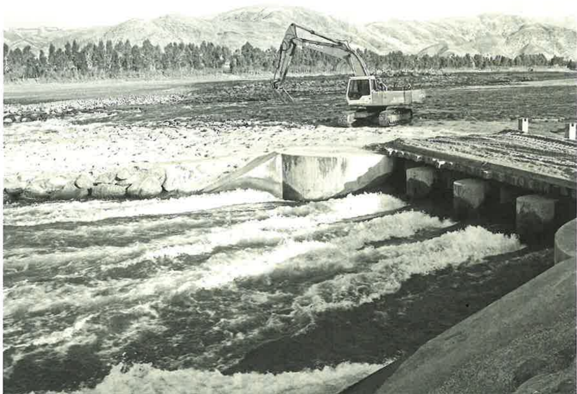
カマ第一堰土砂吐き(2019年1月24日)。取水門前に土砂が堆積しないように、大量に土砂を含む底水を急流で流すと共にクナール河の水位が異常に低い時は、堰板を入れ取水量を確保する。
