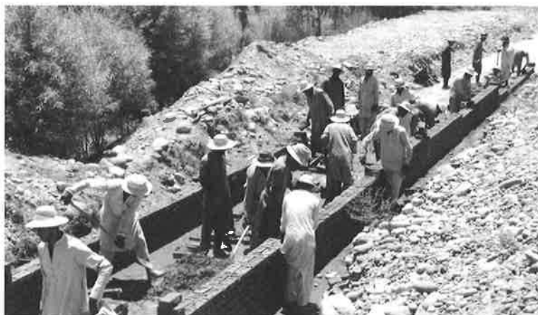
新ペラ用水路延長工事。気温が40度を超える中、50人ほどの作業員が懸命に働いている(2020年7月2日)
