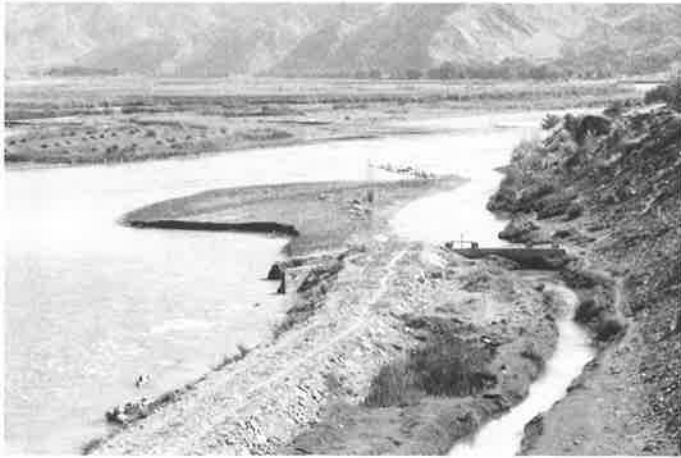
バルカシコートの既存取水門と上流を望む。二つある水門のうち一つは土砂で埋まっている。(2020年10月15日)
