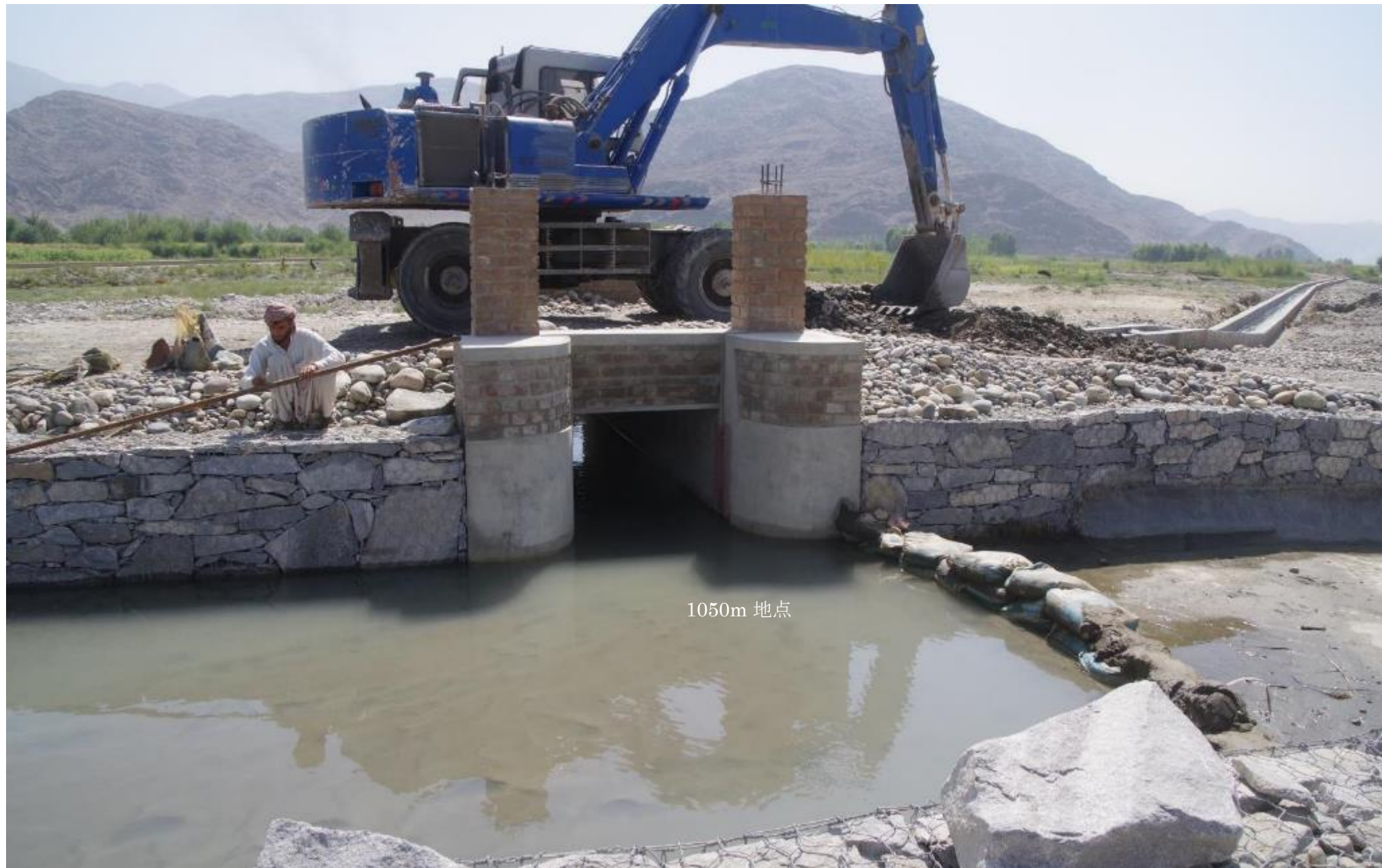
カチャラ II 分水路のとりいれ口。2017 年 9 月 26 日
